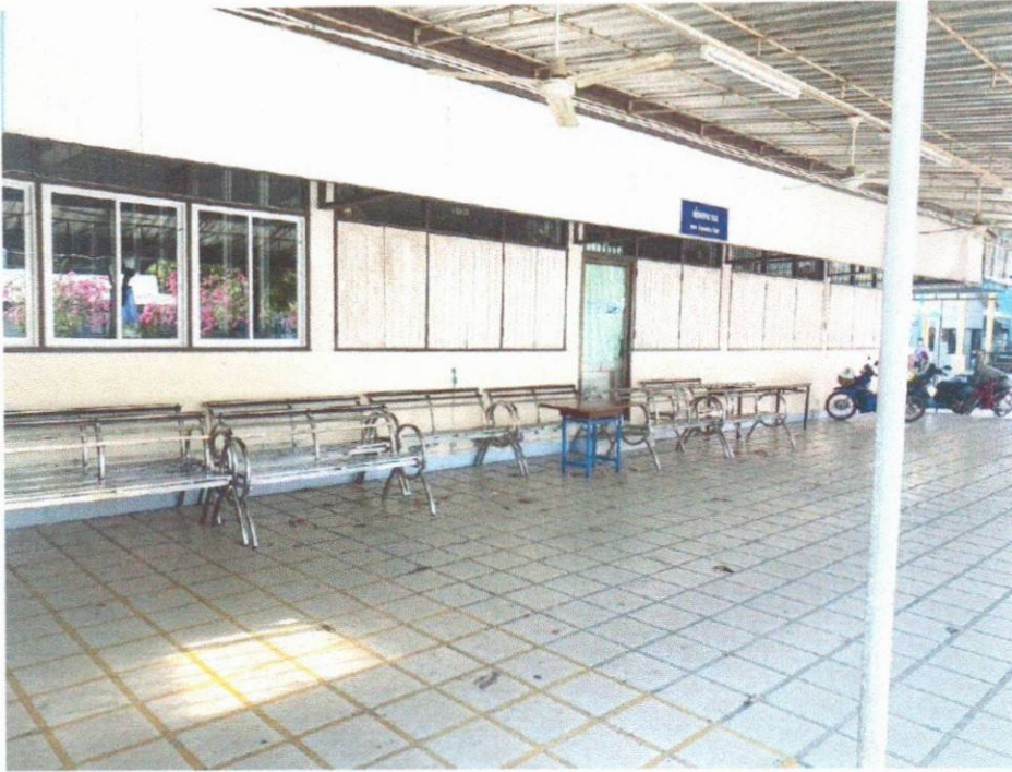
ภาพถ่ายด้านขวา (อาคารคหกรรม แบบ ค.ส.ล. ๑ ชั้น)
